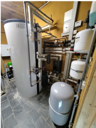
Installation de traitement, photographie EuroSolar [E, p. 9].
